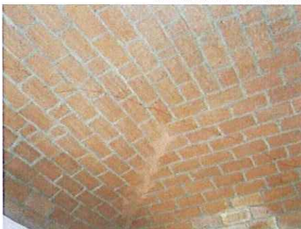
Figura 23 – abobadilhas junto à receção (fissurada)
