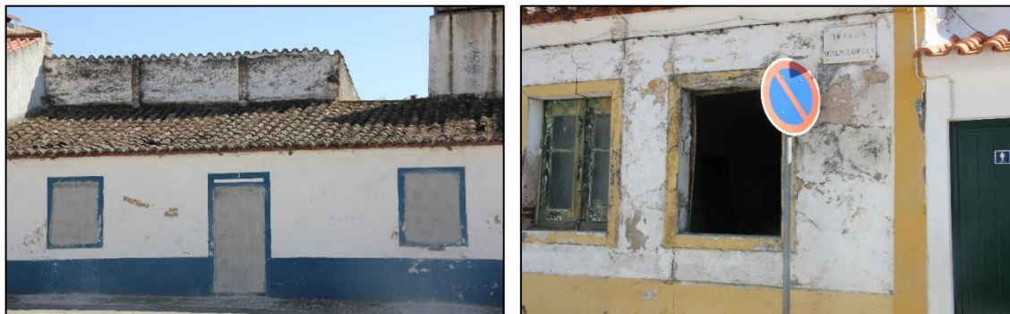
Figura 10 – Exemplos de edifícios com problemas ao nível das caixilharias
