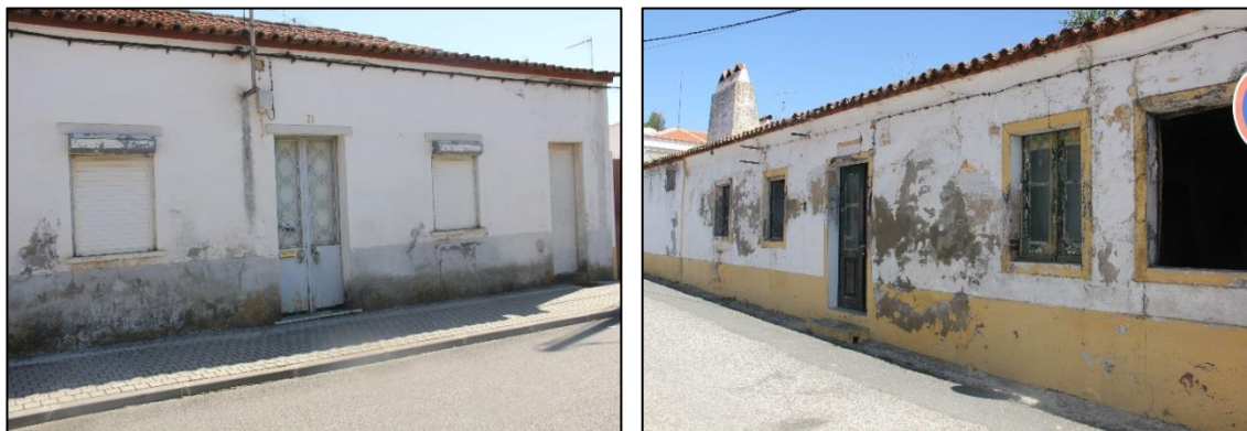
Figura 9 – Exemplos de edifícios com problemas ao nível das paredes exteriores
